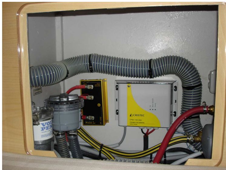
Chargeur dans le compartiment moteur côté cabine bâbord
