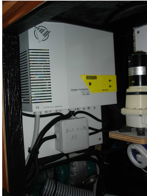
Ladegerät im Motorenraum auf Steuerbordseite
