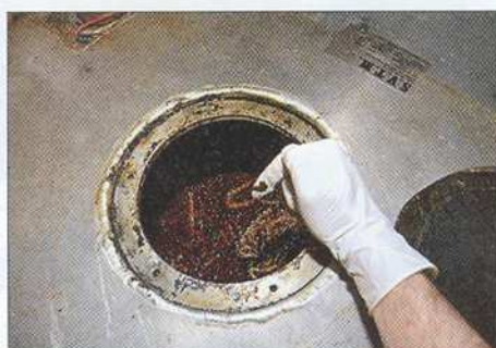
▲ La pollution du réservoir sera arrêtée par le filtre gasoil, mais risque en amont de boucher l'alimentation.
